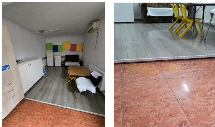
* Diferență de nivel (prag) între gresie și parchet în sala de mese
